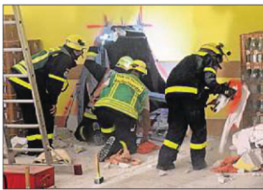
Durch die Wand des benachbarten Getränkemarktes in Mühlried gelangten die Rettungskräfte Freitagabend in den eingestürzten Modemarkt. Anders als befürchtet fanden sie niemand unter den Trümmern. Foto: M. Scheik
